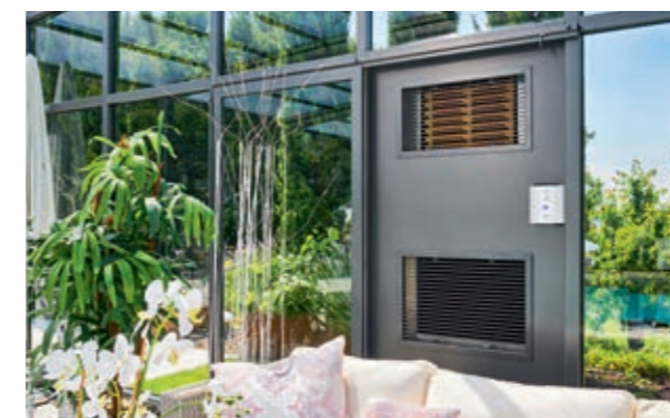
Diese Entfeuchtungsanlage wurde in das größte Element der Poolüberdachung integriert. Sie sorgt dafür, dass jederzeit angenehmes Klima in der Halle herrscht.
